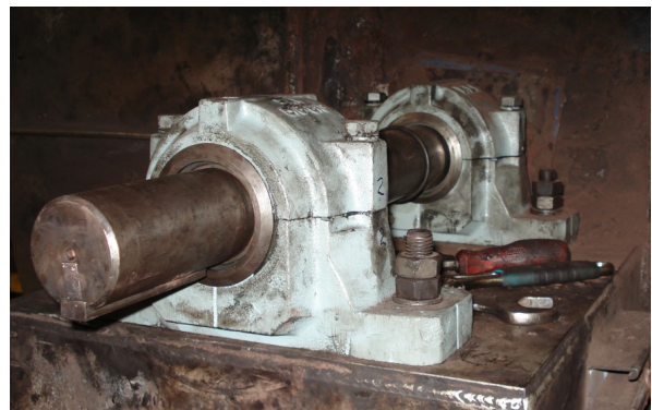
↑ Air Recirculation Fan
