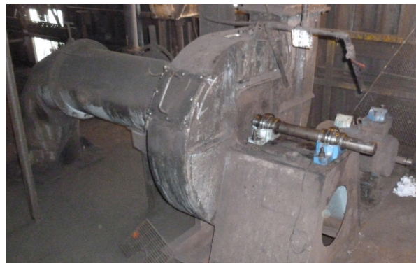
↑ Dust Extraction Fan
